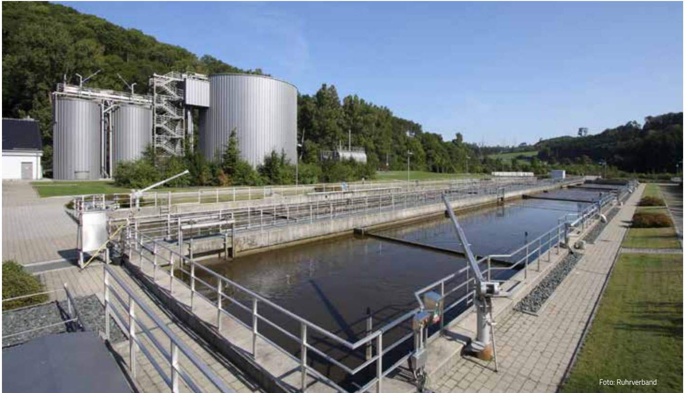
Die Kläranlage des Ruhrverbands in Sundern.
